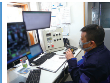
制御室での監視作業
